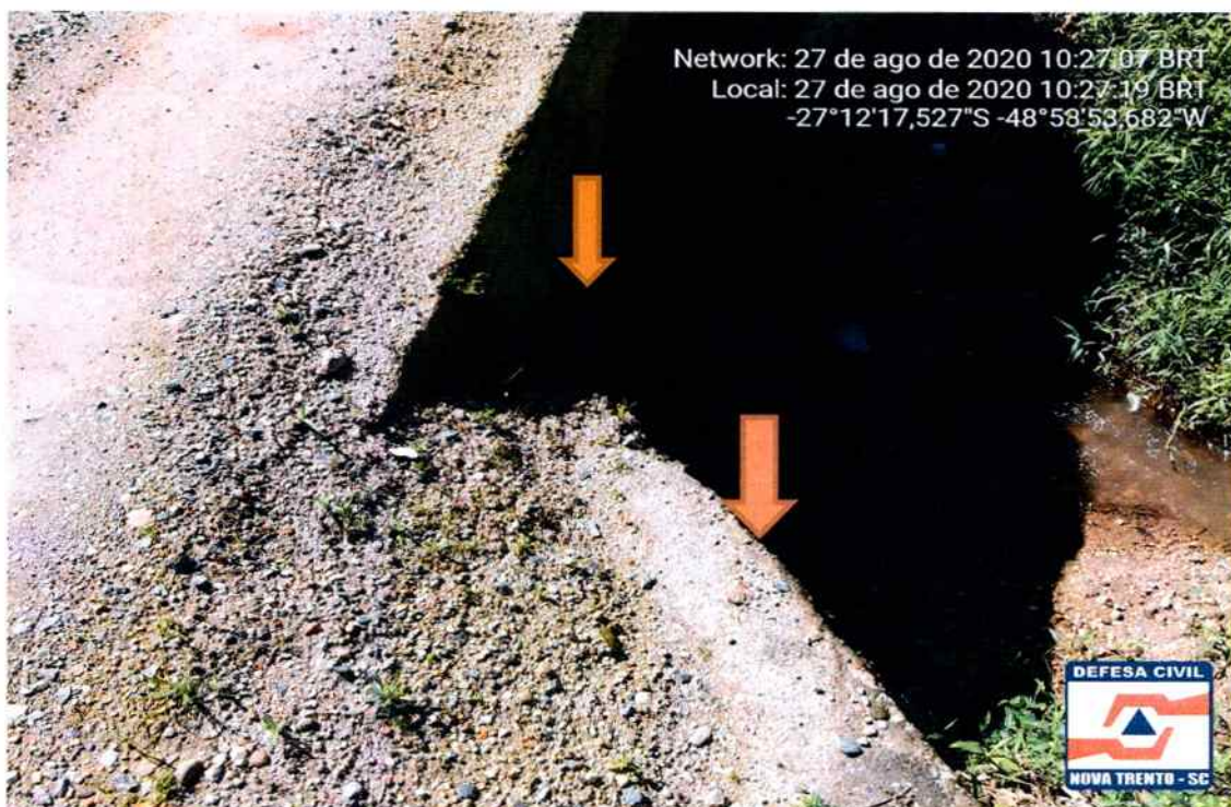
Foto 02: Vista da cabeceira da margem direita com suas alas danificadas.
