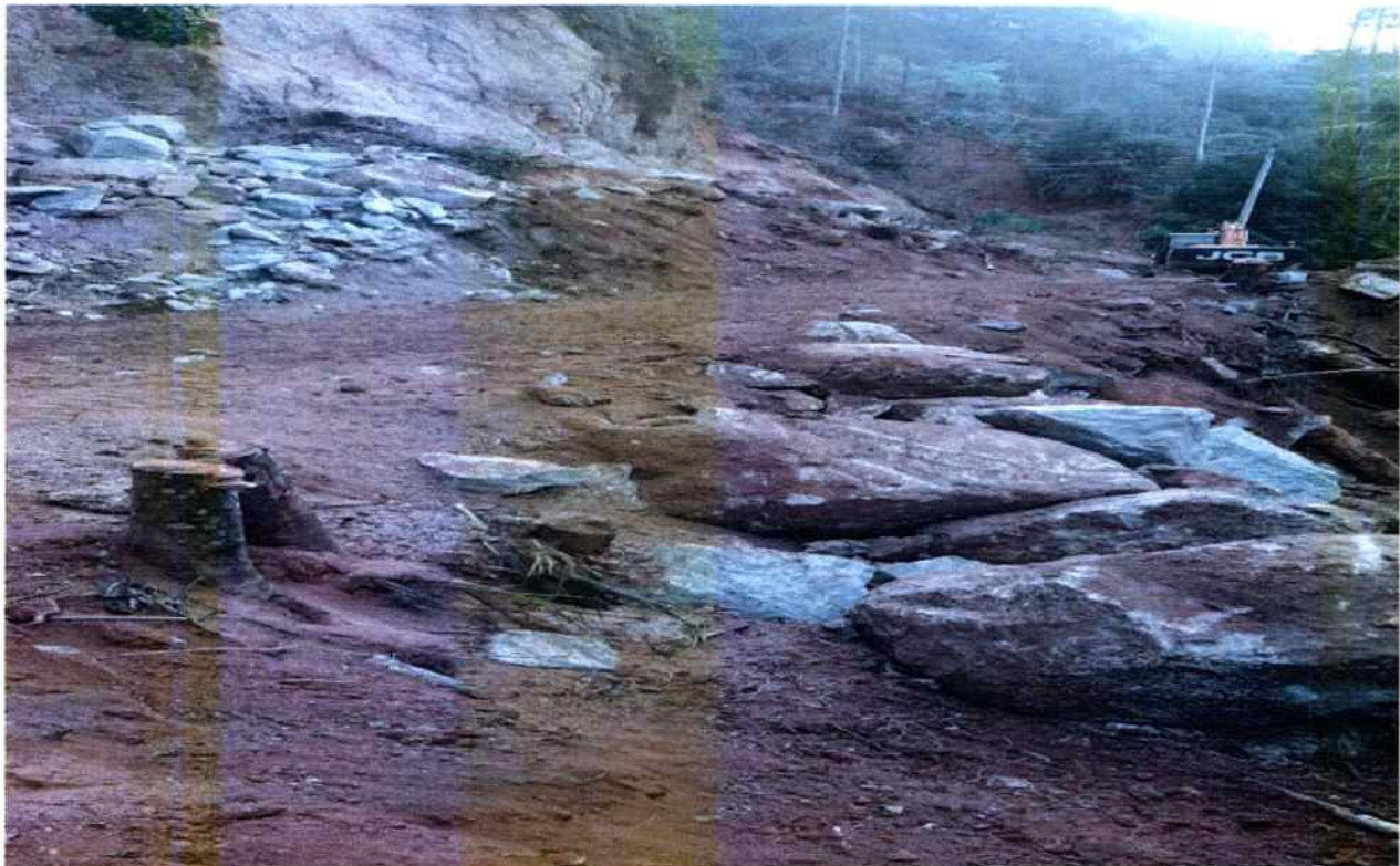
Foto 05: Vista da estrada geral desobstruída após os trabalhos de explosão e limpeza.
