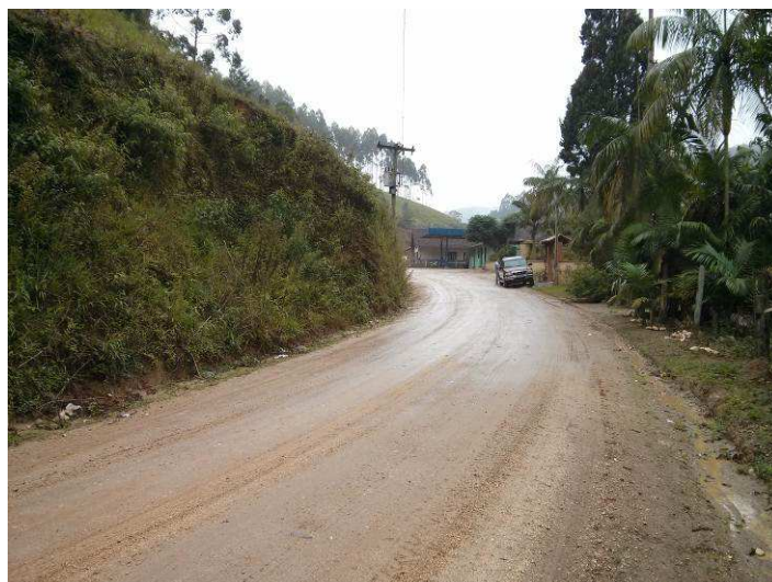
Figura 18: Vista Final do Trecho – Problemas de drenagem
