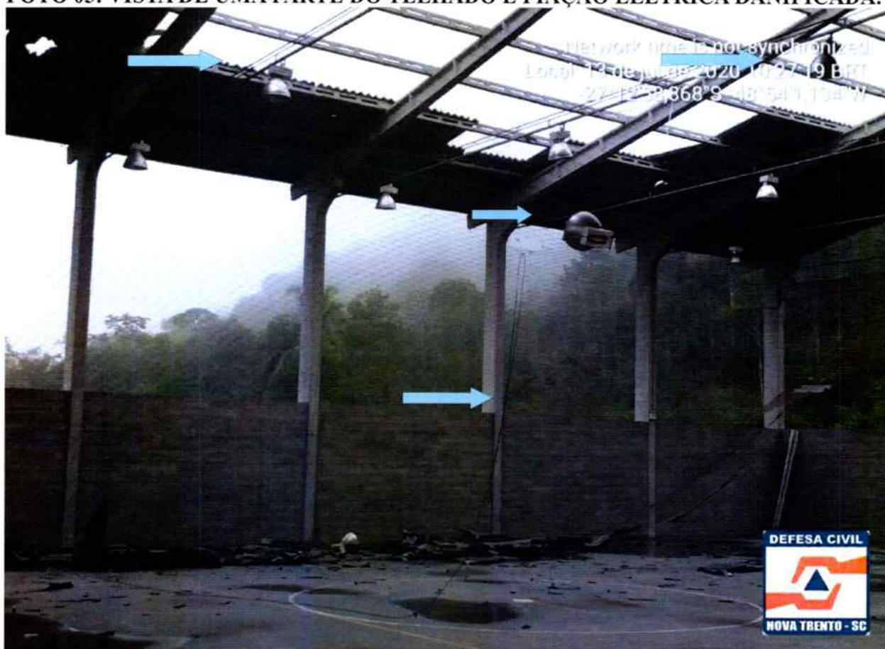
FOTO 06: VISTA DA ILUMINAÇÃO E PARTE ELÉTRICA DANIFICADA PELO ENVENTO.
