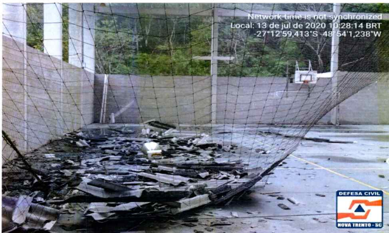
FOTO 03: VISTA DE PARTE DO TELHADO E DAS TELAS DE NYLON DESTRUÍDAS
