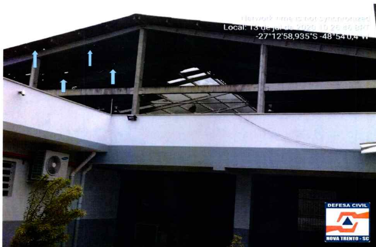
FOTO 07: VISTA DA PARTE FRONTAL DA QUADRA, COM TELHADO DANIFICADO.
