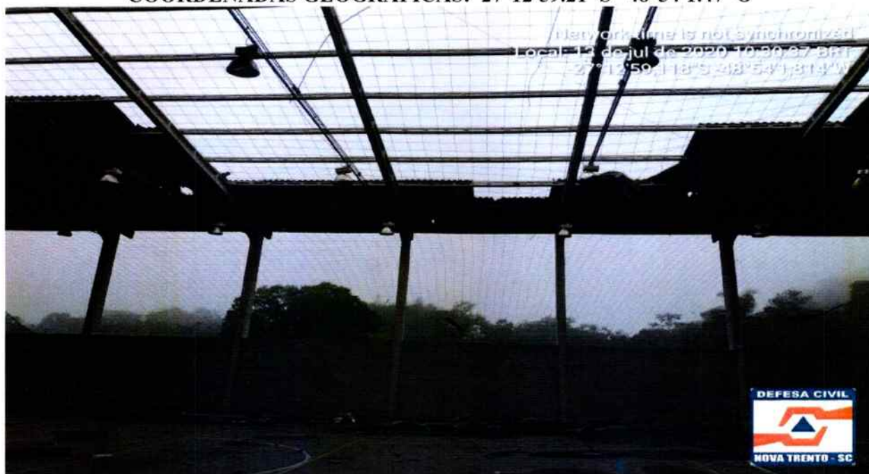
FOTO 01: VISTA PARCIAL DO TELHADO DANIFICADO PELO EVENTO.
