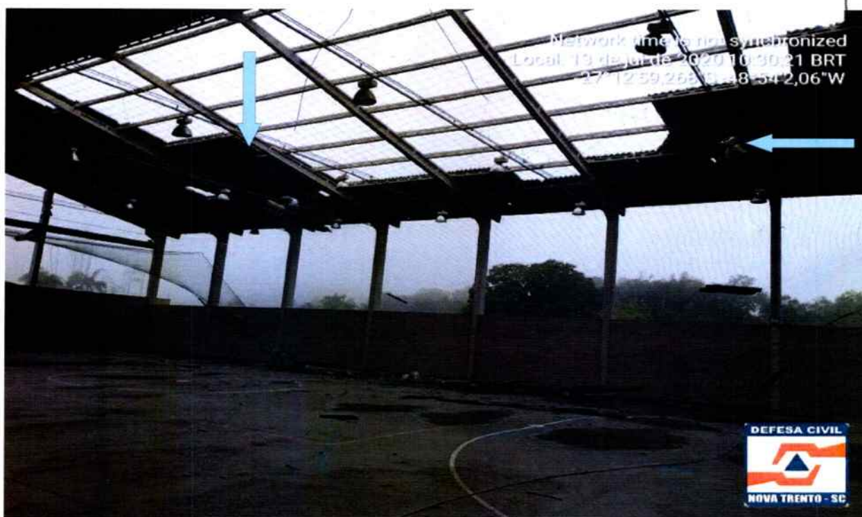
FOTO 05: VISTA DE UMA PARTE DO TELHADO E FIAÇÃO ELÉTRICA DANIFICADA.
