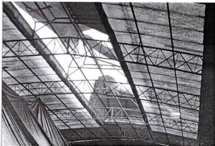
No ginásio Inácio Gullini principais danos foram na cobertura de zinco.
