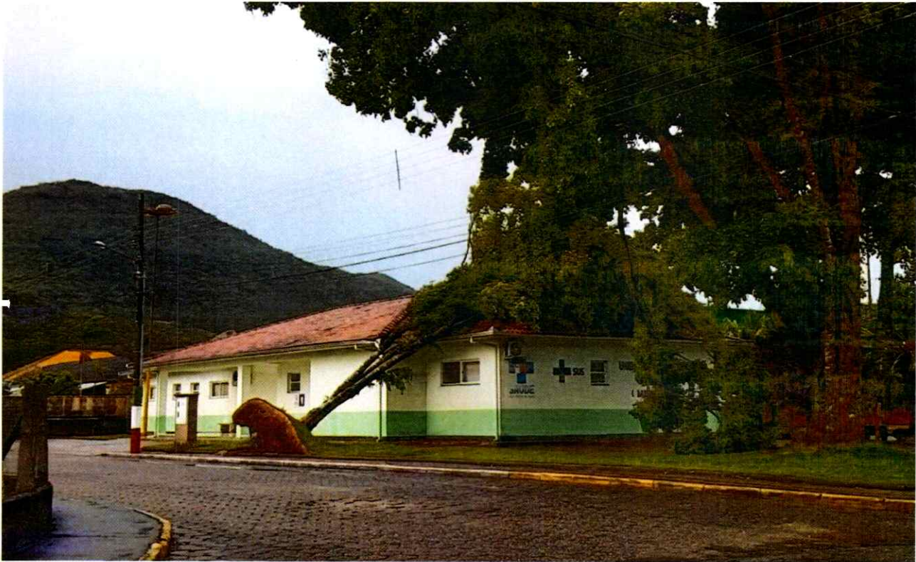
FOTO DO TELHADO DO POSTO DE SAÚDE DO BESENELO ATINGIDO POR UMA ÁRVORE
