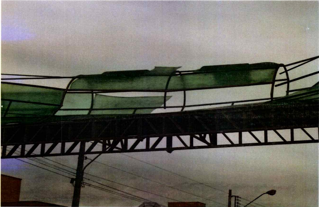
FOTO DA PASSARELA DO COLÉGIO ESTADUAL FRANCISCO MAZZOLA TOTALMENTE RETORCIDA
