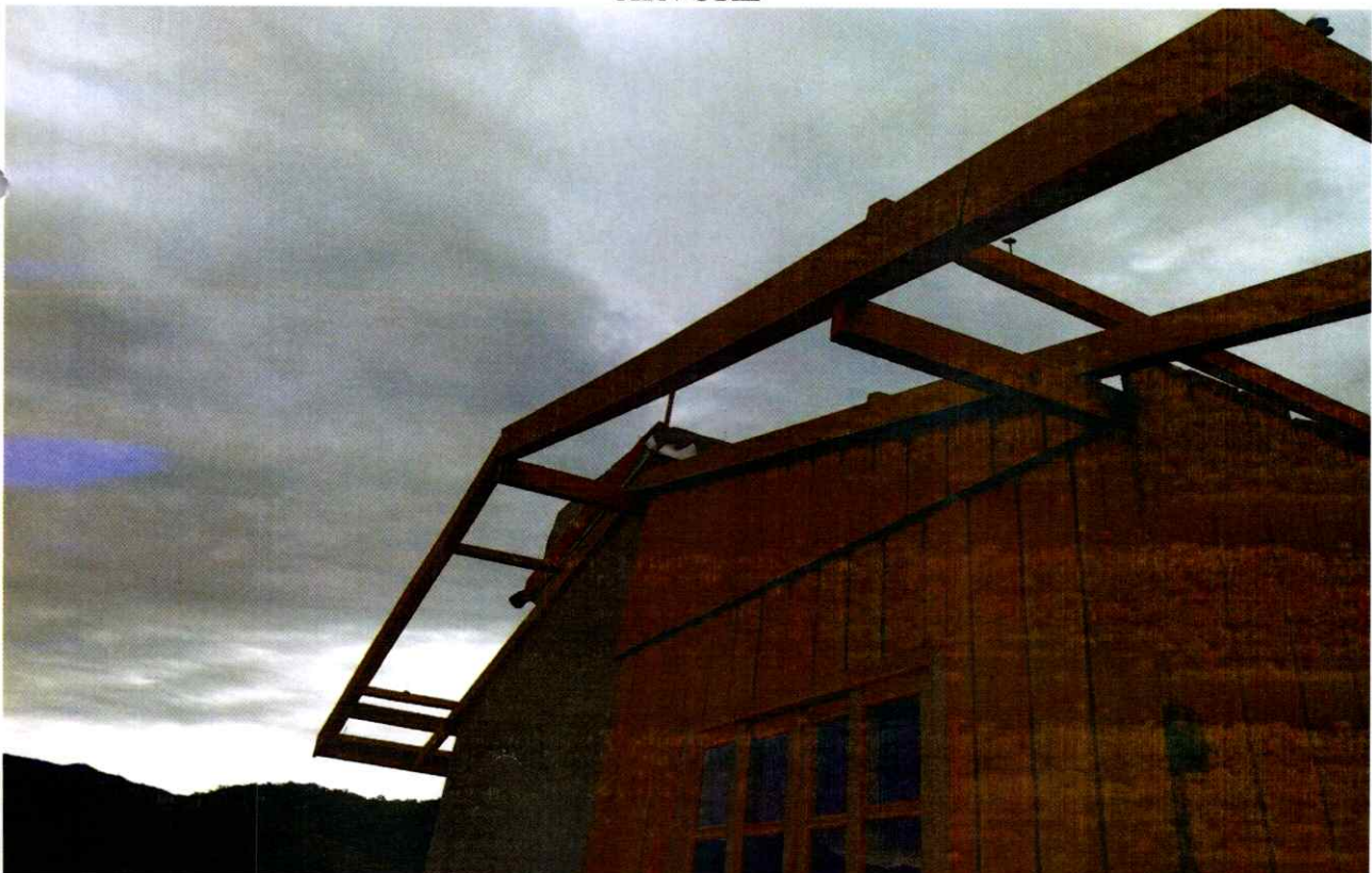
FOTO DE UMA CASA NO BAIRRO TRINTA RÉIS TOTALMENTE DESTELHADA
