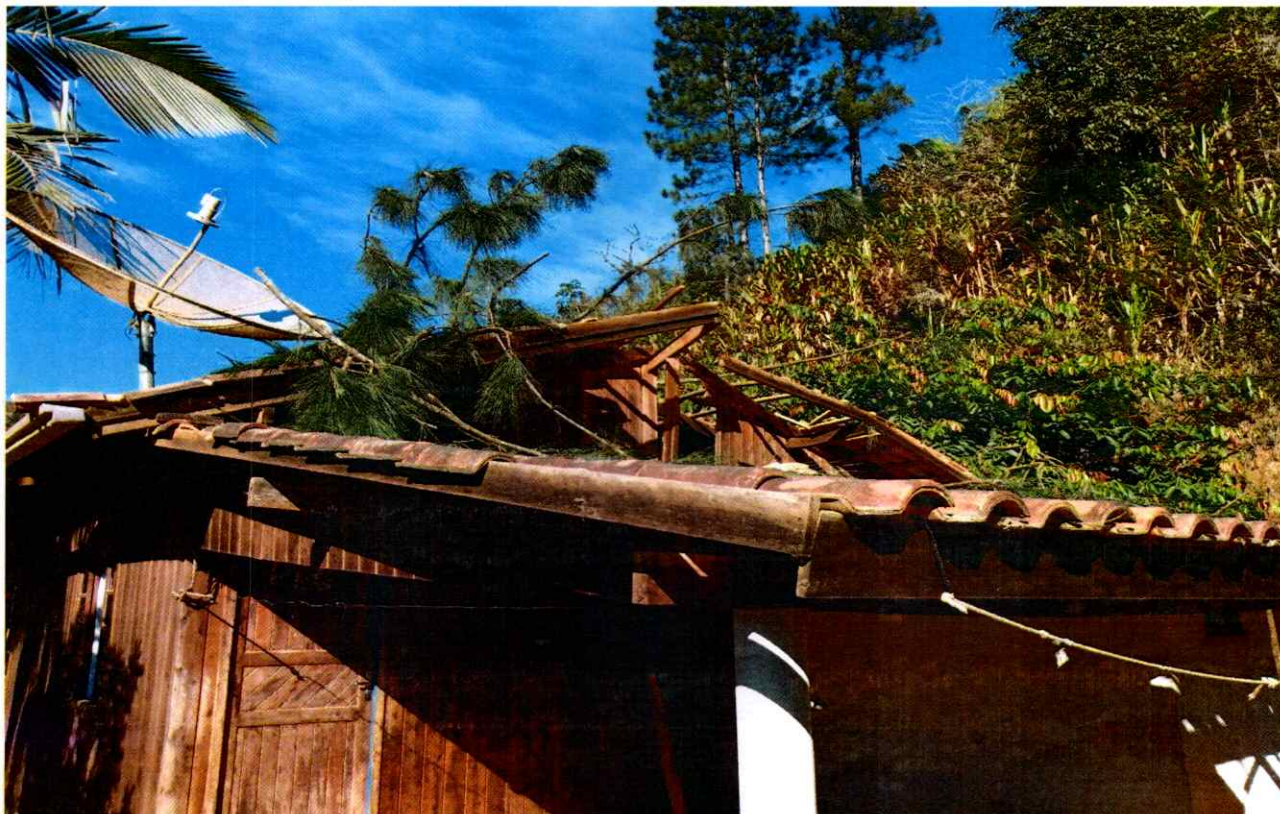
FOTO DE UMA CASA ATINGIDA POR UMA ÁRVORE NO BAIRRO SALTO
